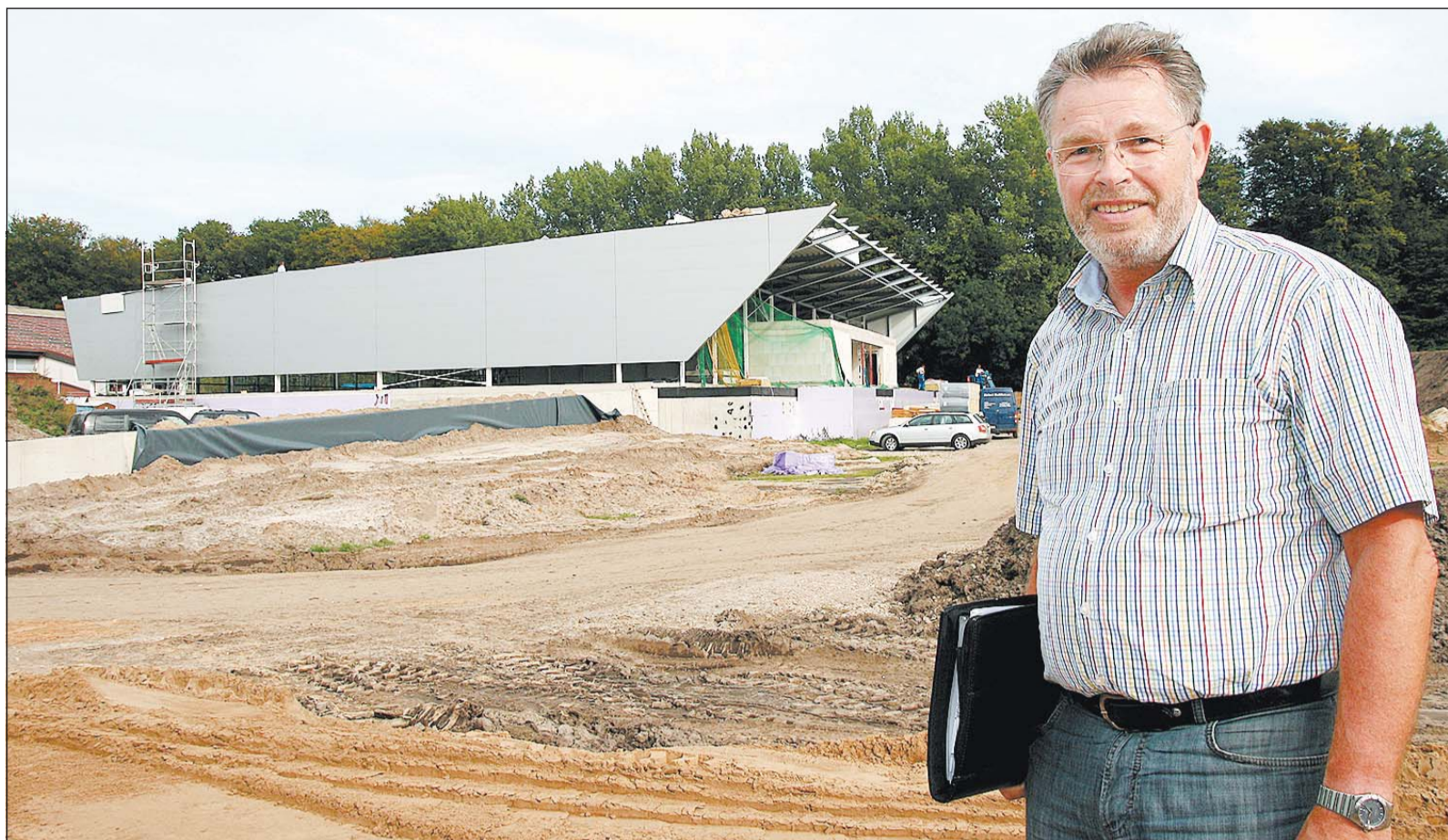
Jens Wurr, Projektleiter des für die Belüftungstechnik zuständigen Unternehmens, ist mit seinem Team derzeit auf der Baustelle
